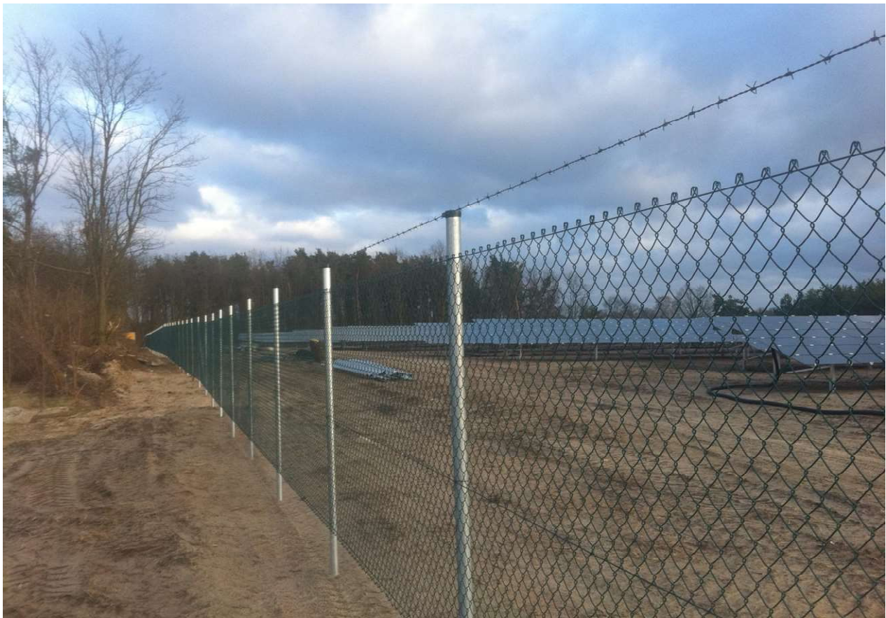
Beispiel der zum Einsatz kommenden Zaunanlage
